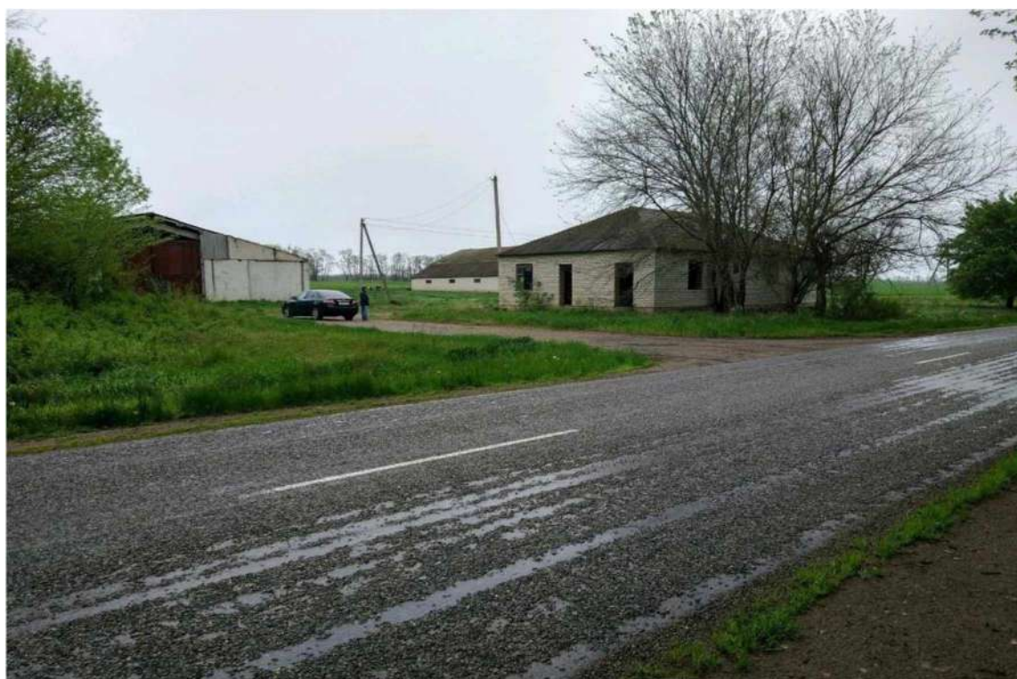
Рисунок 7- Состояние дорожного полотна на улице Красная села Падинского Новоселицкого района (автомобильная дорога Новоселицкое-Падинское-Калиновка в границах села Падинское)
