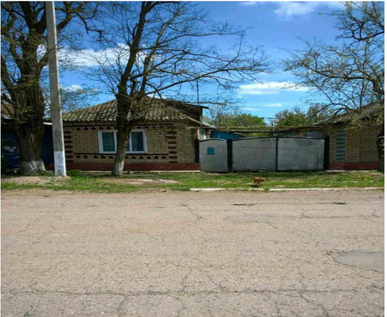
Рисунок 3 - Состояние дорожного полотна в селе Новоселицком Новоселицкого района
